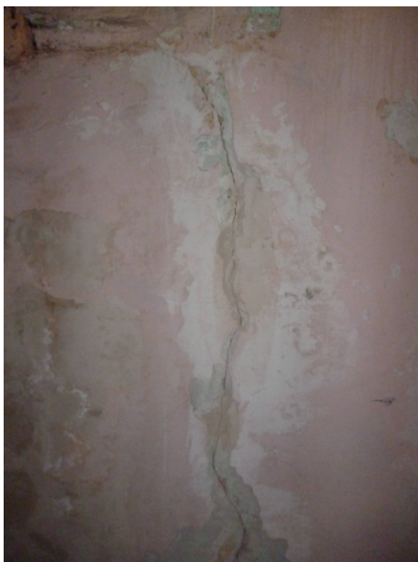
Рисунок 7 – Дефекты конструкций подвала. Других повреждений конструкций здания не обнаружено.
