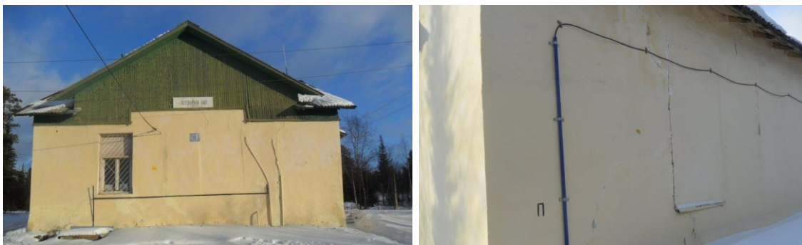
Рисунок 3 – Здание вокзала на станции Ягельный Бор: а – главный фасад; б – фасад здания с трещиной
