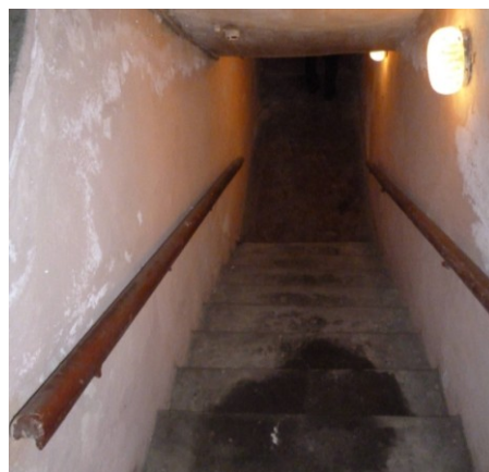
Рисунок 6 – Подвал здания контрольно-испытательного пункта, расположенного по адресу: город Мурманск, улица Портовый проезд, дом 46, корпус 1
