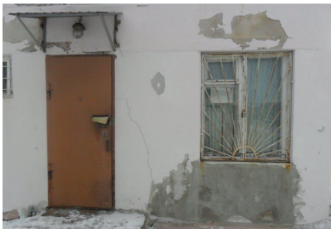
Рисунок 9 – Дефекты конструкций здания
